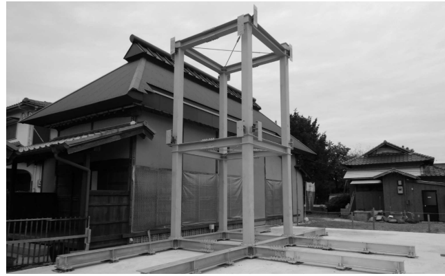
1. 耐震補強の鉄骨 耐震診断を実施し、大地震時に倒壊する恐れのないよう、内部に補強鉄骨を組み入れています。
